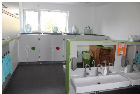
Kindertoilette mit Wickelbereich
